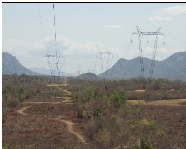
Foto 13 - Linhas de alta tensão da CHESF que interceptam a bacia hidráulica do futuro reservatório em seu trecho mais a montante (E-301.661; N-9.576.553).
