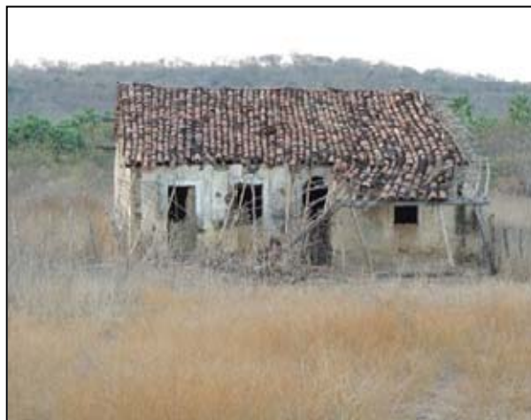
Foto 10 - Habitação abandonada, situação bastante comum na região, dado a carência hídrica (E-303.923; N-9.680.436).
