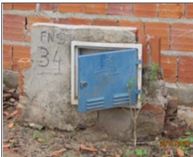
Foto 17 – Rede de distribuição d’água da CAGECE, que atende as áreas das localidades de Caiçara I, Caiçara II e Vazante.
